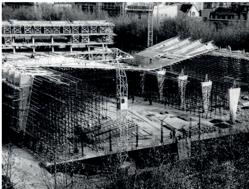
Maqueta y construcción de la nueva Sede de la UNESCO, en París, 1955. Los arquitectos a cargo fueron Marcel Breuer (Estados Unidos), Pier Luigi Nervi (Italia) y Bernard Zehrfuss (Francia), quienes fueron aprobados por un Comité Internacional. © UNESCO/Archives
